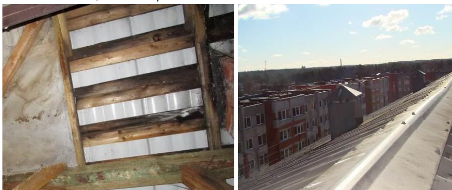
4.8.5 att. un 4.8.6 att. Ventilācijas izvads virs jumta
