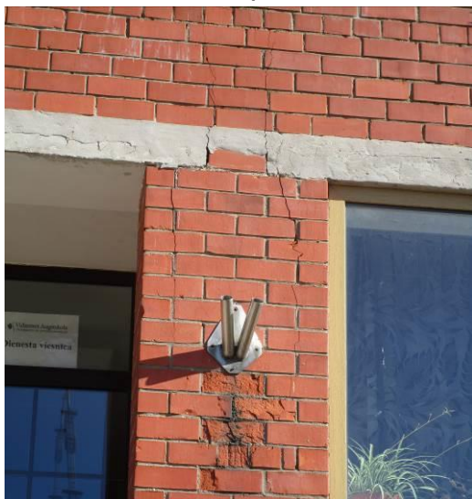
4.2.10 att. Dzelzsbetona ailu pārsedzes
