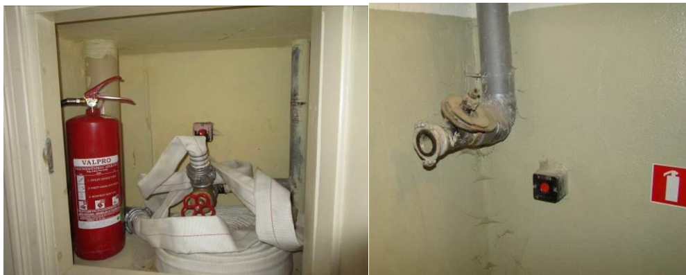
5.3.3 att. un 5.3.4 att. Iekšējās ugunsdzēsības hidrants
