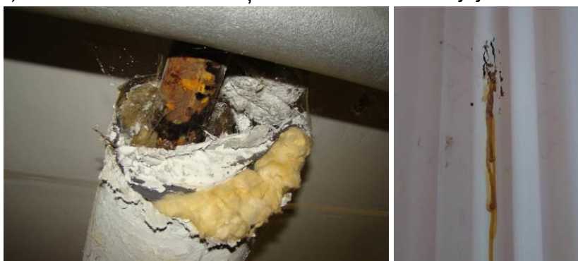
5.4.1 att. un 5.4.2 att. Bojāti apkures cauruļvadi
