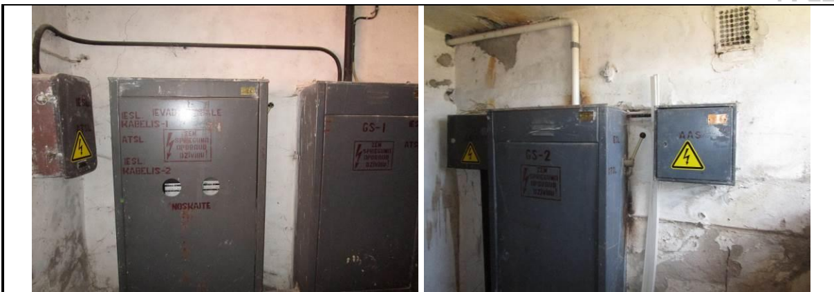
5.9.1 att. un 5.9.2 att. Sadales skapis
