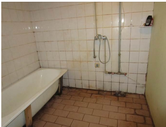
5.1.3 att. Neizremontēts sanmezglis
