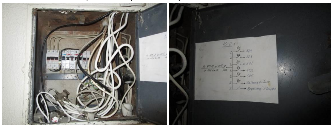
5.9.3 att. Spēka kabeļi sadales skapī
