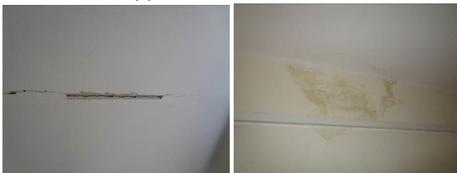
4.18.1 att. un 4.18.2. att Plaisas pārsegumu saduršuvē un mitruma bojājumi Ēkas atjaunošanas vai pārbūves gadījumā ieteicams veikt kosmētisko remontu un
