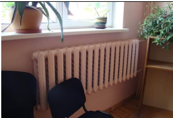
5.5.1 att. Čuguna daudzsekciju radiatori Pagrabstāva telpā tika konstatēts arī konvektora tipa radiators.
