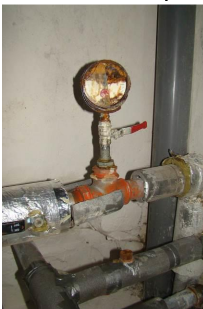
5.4.4 att. Korodējuši/bojāti mērinstrumenti
