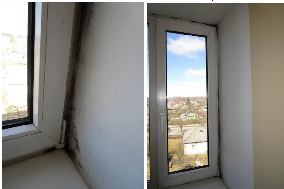
4.13.2 att. un 4.13.3. att Mitruma bojājumi logu ailas apdarē
