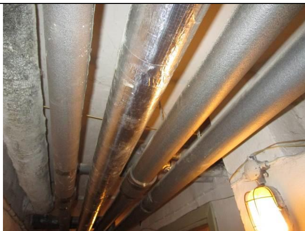
5.1.1 att. Karstā ūdensapgādes caurules
